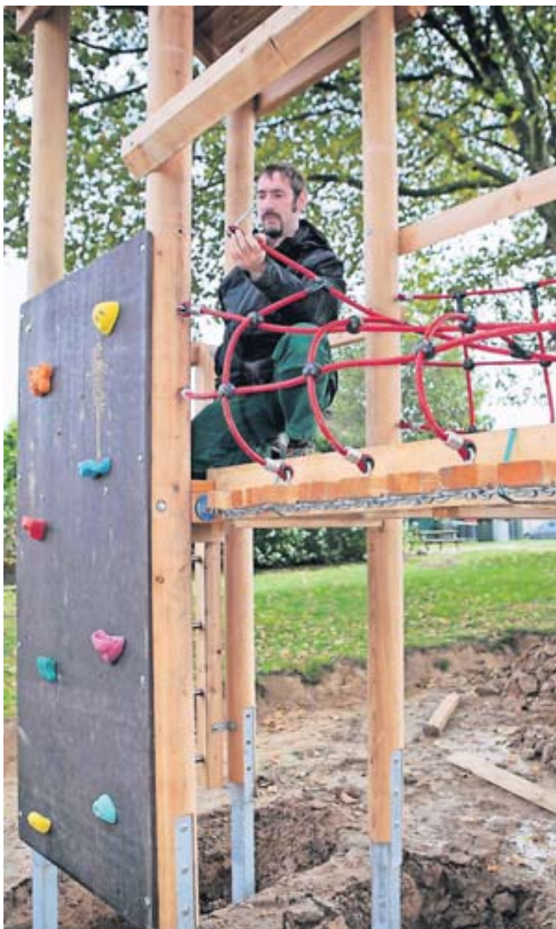
Stefan Broich montiert den neuen Spielturn auf der Anlage in Bedburdyck. Dort werden neue Spielgeräte für rund 25 000 Euro aufgebaut. RP-FOTO: ANJA TINTER
